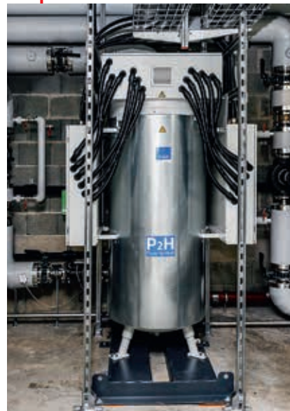
Die Power-to-Heat-Anlage ist ein wichtiger Baustein der Wärmewende.
